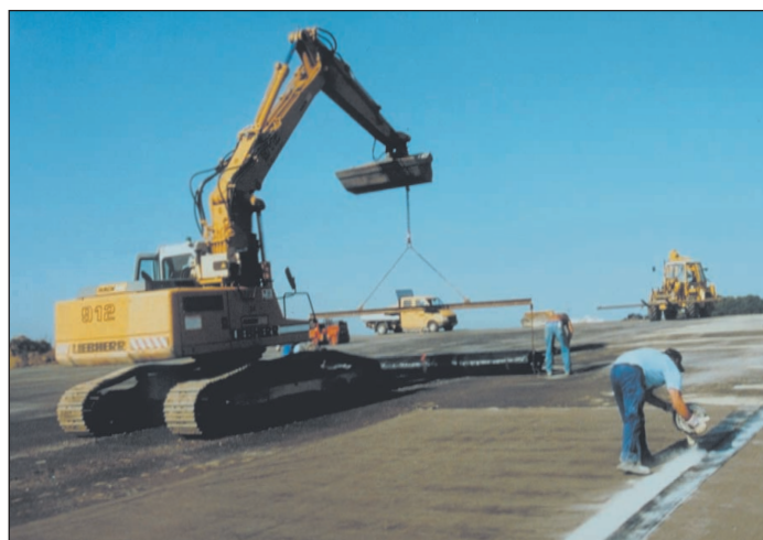
NaBento® - Instalação em um aterro sanitário.
