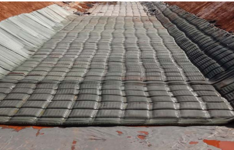
Construcción de canales Brasil | Revestimiento del fondo de un canal con Incomat Flex.
