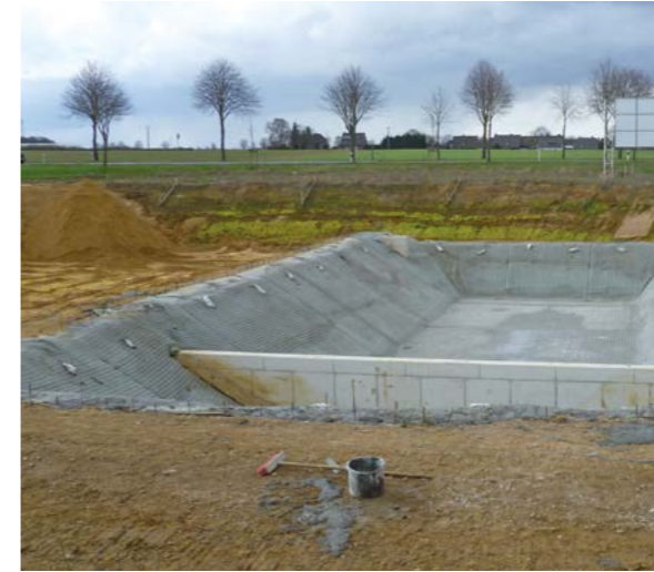
Revestimiento de una balsa de aguas pluviales Alemania | Impermeabilización de una balsa de aguas pluviales con Incomat Standard.
