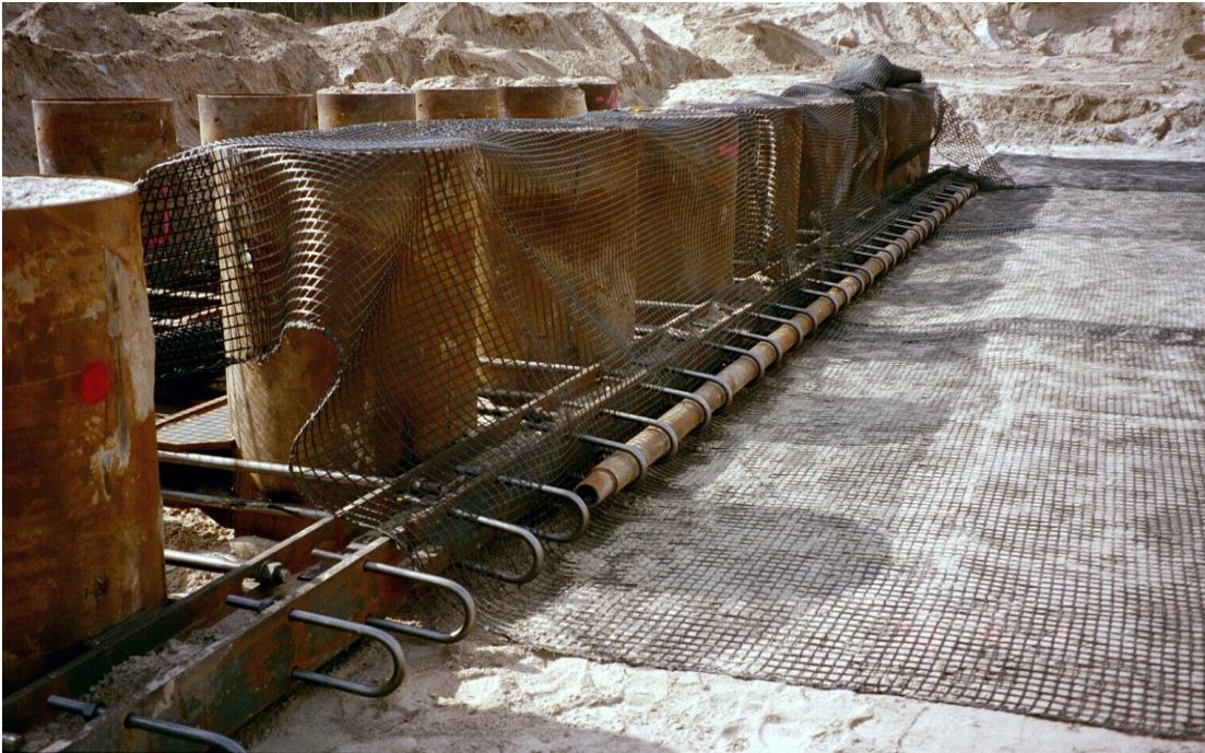
Abb. 6: Fußsicherung eines 15 m hohen Autobahndammes an der A 20 bei Tessin durch mit Geogitterbewehrung rückverankerte Pfahlreihen
