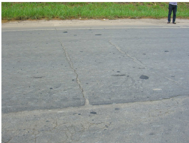
Figura 3 – Vista do pavimento da MG-424 antes da restauração.
