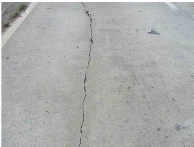
Figura 6 – Trinca longitudinal da placa na Estaca 147.
