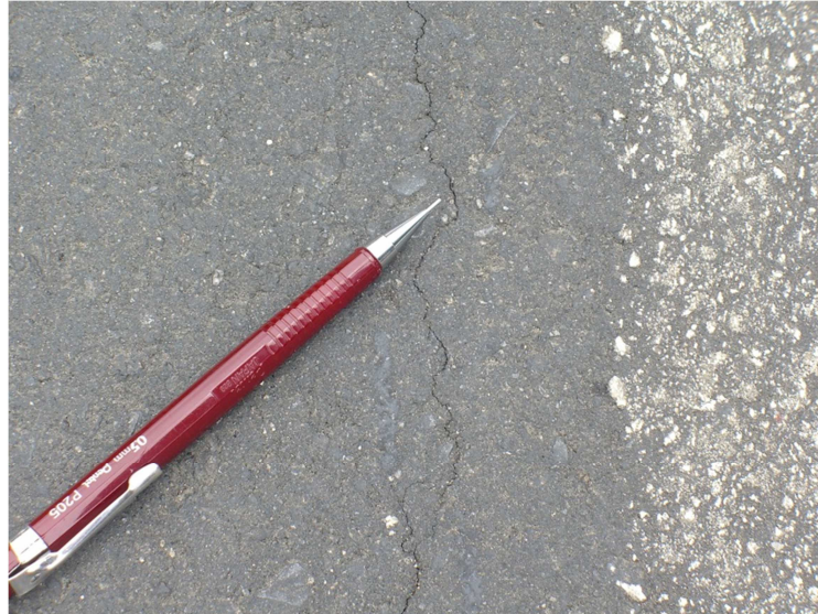
Figura 14 – Surgimento da trinca / junta proveniente a placa de concreto de cimento Porthand.
